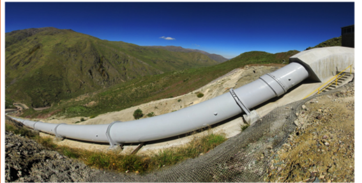
Çukurçay HES Cebri Boru Hattı
